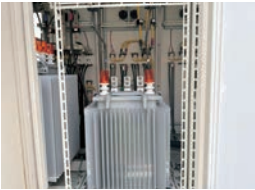
ユーティリティ最適化(変圧器)
