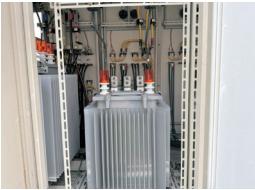
ユーティリティ最適化(変圧器)
